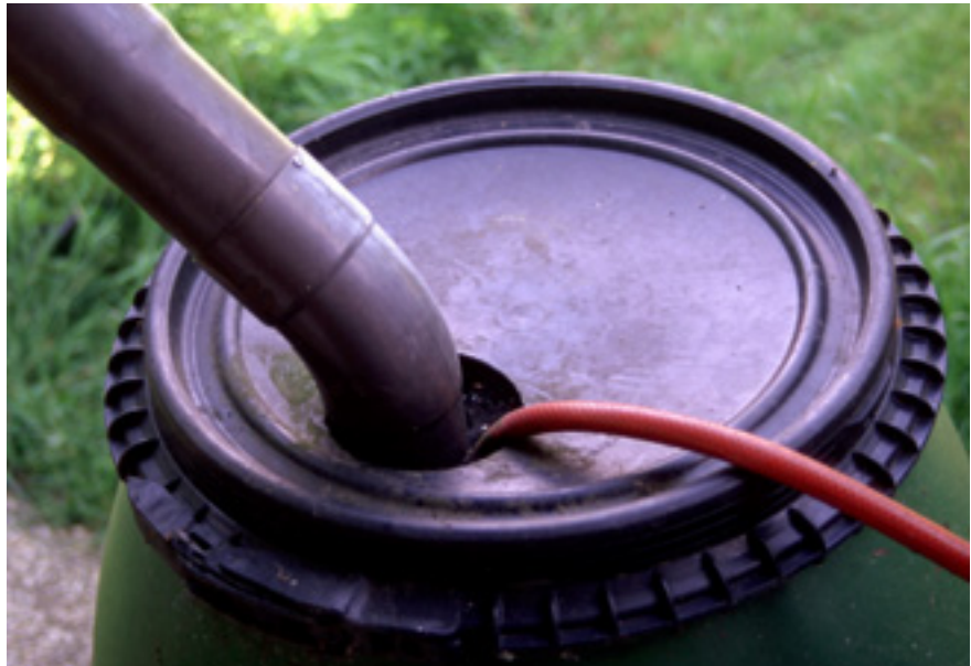
Abbildung 22: Gesichertes Wasser- fass
