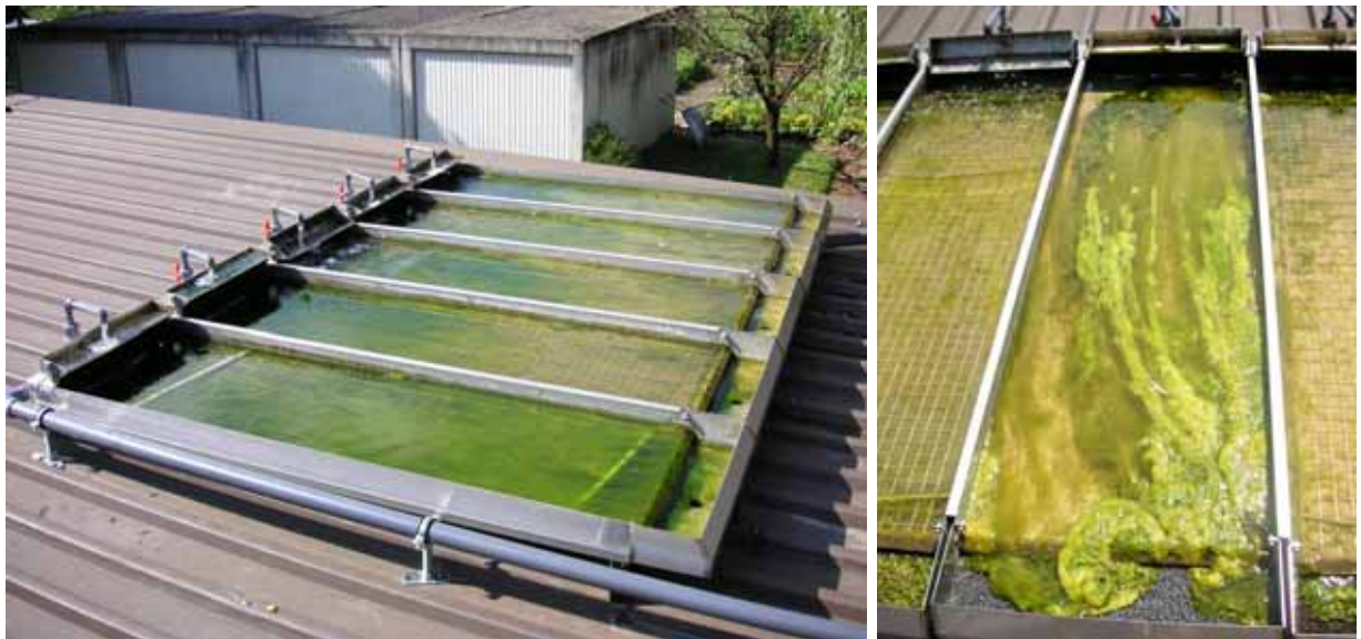
Abb. 2: Fünf Algenrasenfilter reinigen Schwimmteichwasser auf dem Garagendach
